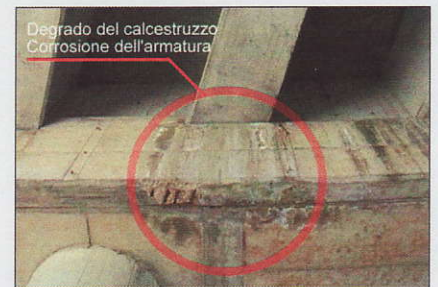
Figura 5 - Il rilievo di degrado del calcestruzzo
